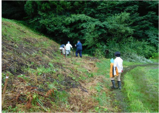
大山地区馬町にある「ため池」では堤体の法面から漏水を確認
