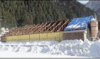
豚舎の屋根飛散 (小名部地内)
