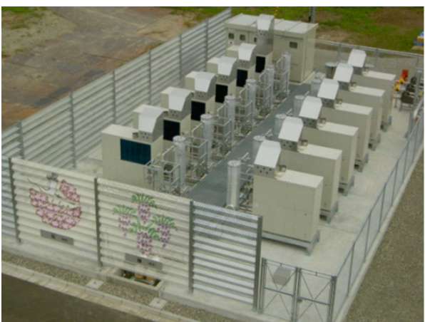
消化ガス発電設備（市HPより引用）
