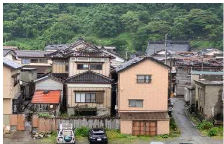
屋根瓦の落下が多数発生した
