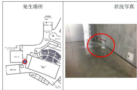
8月10日少量の雨漏りが見つかった文化会館
