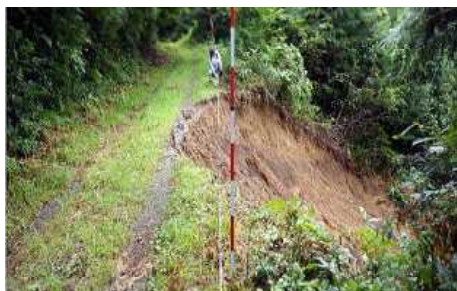
8月5～6日の大雨で林道五斗畑線の路肩・路面崩壊
