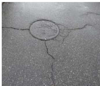
マンホール周りに亀裂
