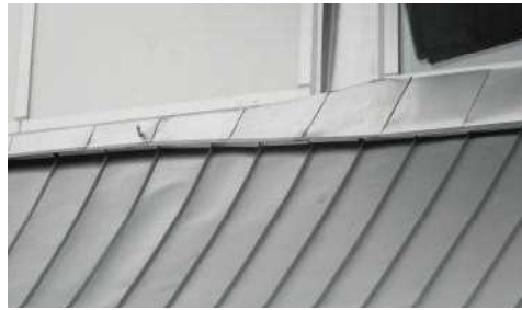
文化会館の屋根・外壁のゆがみ
