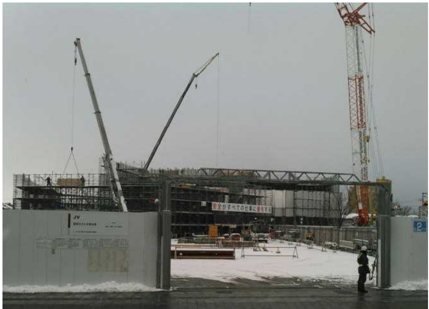
鶴岡市文化会館改築工場の様子 設計労務単価の上昇で事業費が1億8700万円増額になる(3月2日撮影)
