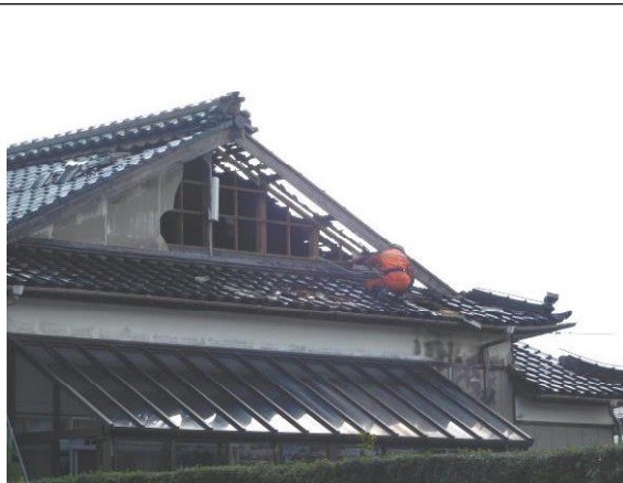
11月2日深夜の1時9分頃、八色木平田31で住宅に落雷し、2階屋根から炎と煙を確認。消防車両が出動しました。雷注意報が発令され、羽黒や櫛引地域には降雹もあり、庄内柿に被害が広範囲に発生しました。
