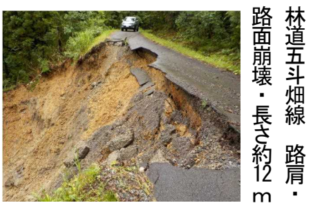
林道五斗畑線 路肩・路面崩壊・長さ約12m 市道添川筋沢線 道路崩壊・土砂流出・長さ約17m（写真・藤島庁舎）
