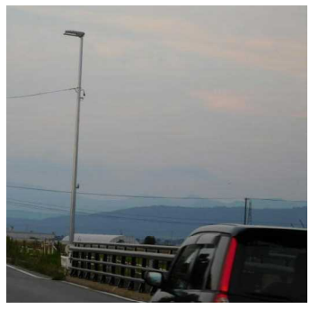
古郡南側の藤島川にかかる県道44号線の保合(やすあい)橋に、柳久瀬町内会が県に要望していた街路灯が設置されました。(写真上・9月8日電柱設置、下・9月21日LED照明設置)
